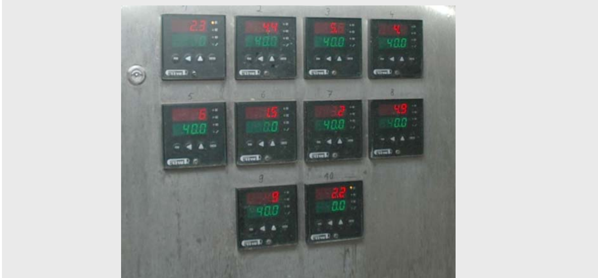
Control de temperatura Tanques
