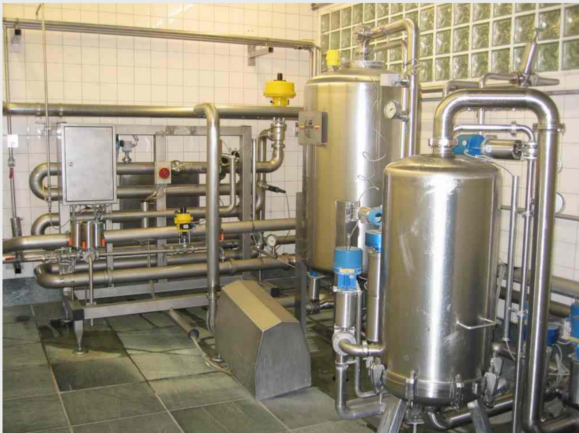
Filtre "Trap", cuve tampon et CO 2 -Carbonisation
